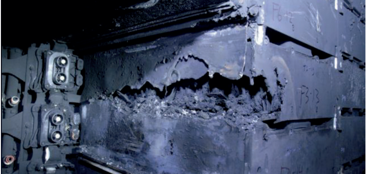
MS Ytterøyningen, batteribrannen ødela kapslingen i stål. Foto: Kripos.
