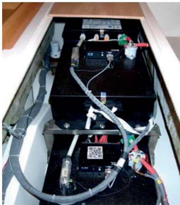
Batteriene før brannen. Kilde begge foto: https://www.youtube.com/watch?v=ImOXKr18Ezw
