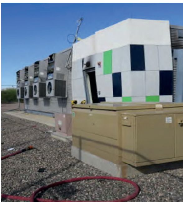
Bilde viser skadene etter eksplosjonen. Hele bygget buler og ståldøren er blåst av hengslene.
