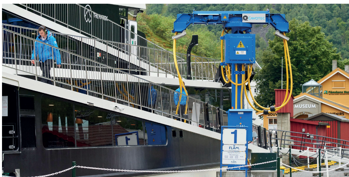
Fjernstyrt landstrømskobling ved kai i Flåm. Foto: CAVOTEC.
