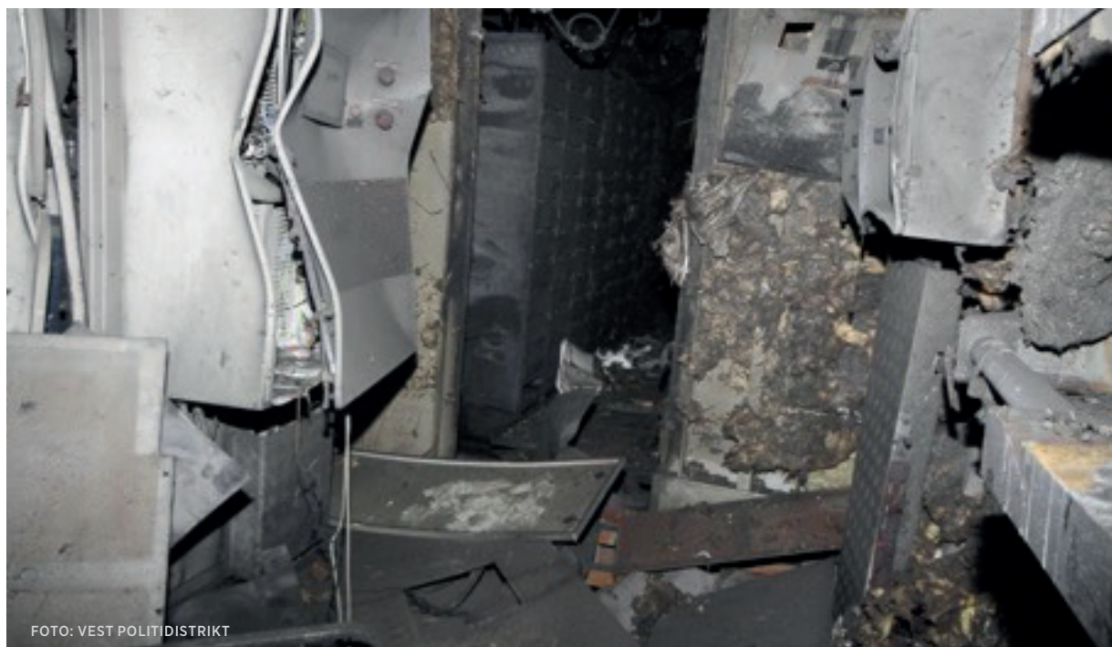
Teknisk rom MS Ytterøyningen før eksplosjonen.
