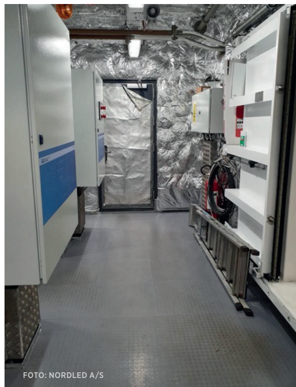
FOTO: NORDLED A/S Teknisk rom MS Ytterøyningen før eksplosjonen.
