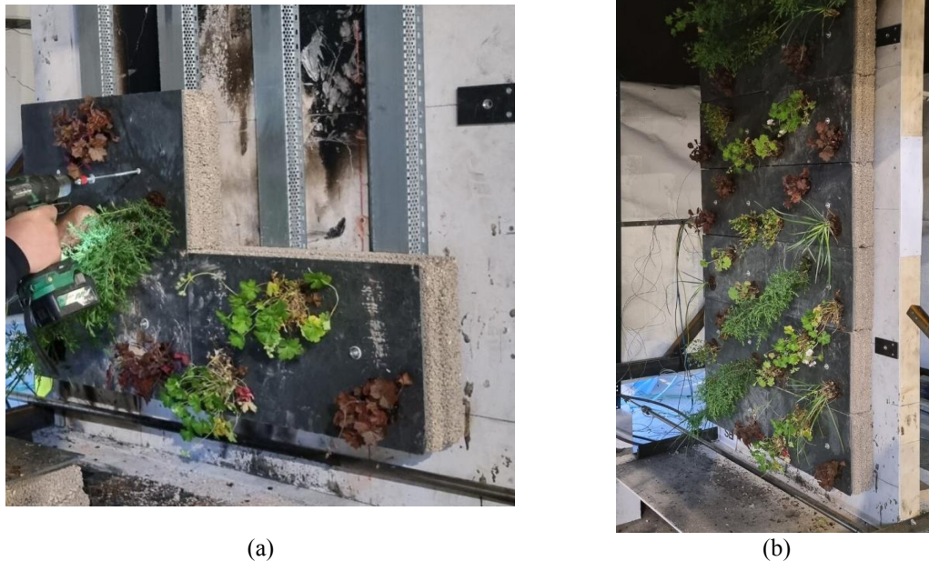
Figur 3-4 (a) Montering av elementa i det ubrennbare plantesystemet på vegg og (b) ferdig montert vegg med planter.
