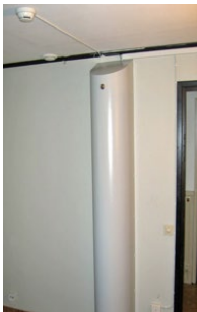
Figur 2-2: Et installert mobilt vanntåkeanlegg, med detektor i taket og en rund dyse øverst på tanken. (Foto: FIRESAFE AS)
