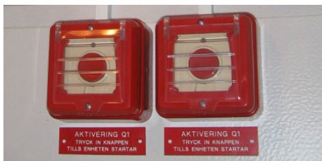
Figur 2-5: Bilde av manuelle brytere for aktivering av mobile vanntåkeanlegg. (Foto: FIRESAFE AS)
