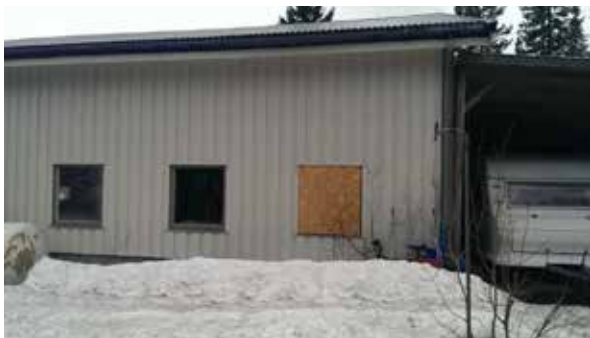
Bakvegg mot øst. Ett vindu knust (blåst eller sugd ut).
