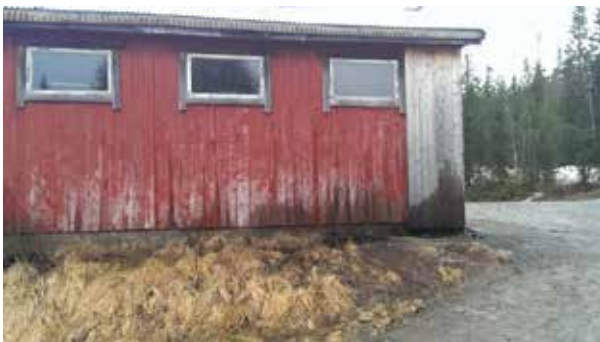
Sidevegg mot øst med vindu. Ingen knust.
