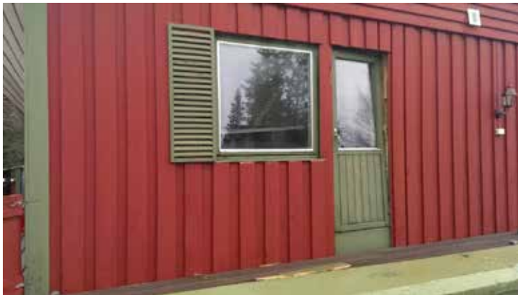
Vestside. Dør presset inn.
