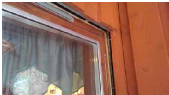
Fasade mot nord. Ingen knuste vinduer, men skjøvet inn + strukturelle skader inne.
