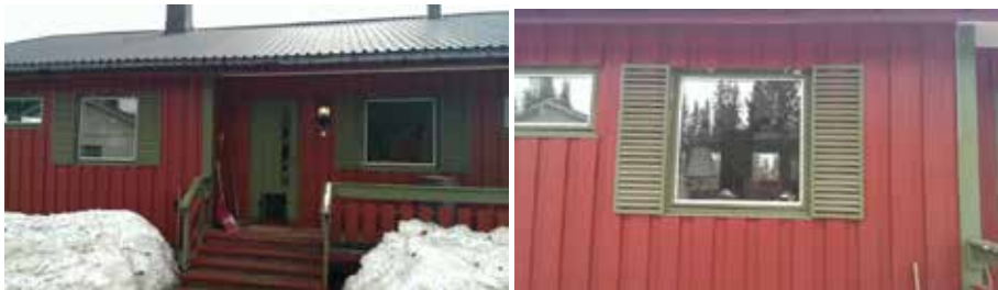
Nordside. Vindu skjøvet inn. Kun vindu i dør som er knust.
