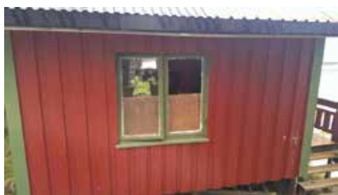
Bilde fra vest. Ett av to vindu knust. (Skjernet av typografi/vegetasjon?)
