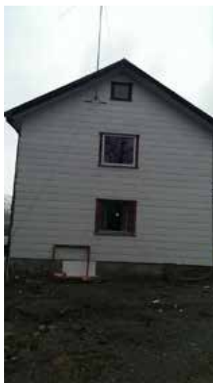
Østvegg. Ett av to vindu knust. (Blåst ut?)
