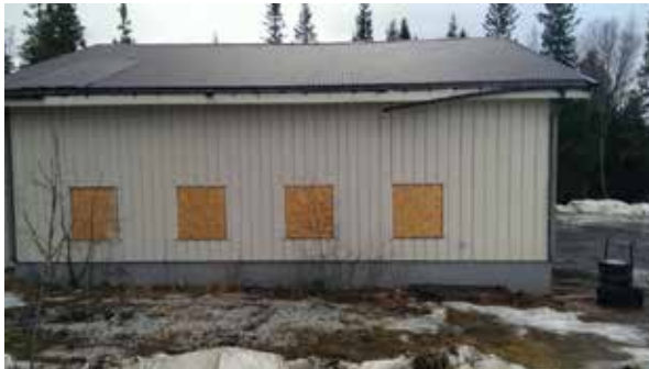
Langvegg mot vest. Fire av fire vindu knust. Takrenne henger.
